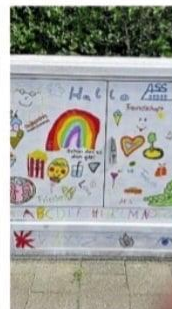
Kunterbunt wie die Welt sollen die Stromkästen auf dem Wedeler Elbhochufer werden.
