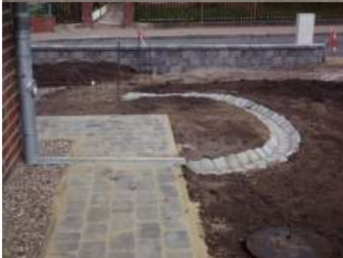
Versickerung im Vorgarten
