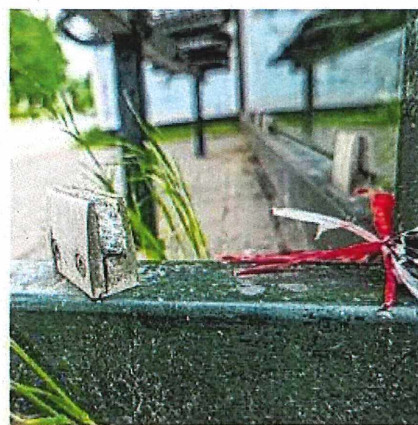
Nur die Halterung und Scherben blieben übrig: Insgesamt 29 Scheiben von Bushäuschen wurden in Wedel in den vergangenen Monaten zerstört.
