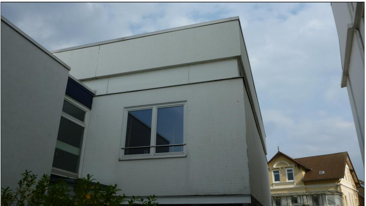
Abb. 5: Rückwärtige Ansicht des Gebäude Hafenstraße 28 – Einflugmöglichkeiten an der Attikaverkleidung sowie an den Spalten der Betonelemente.
