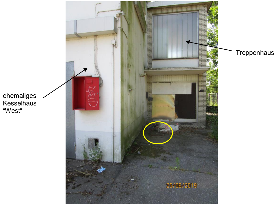
Foto 5: Blick nach Westen auf das rückwärtige Treppenhaus und den dort gelegenen Schacht (s. gelber Kreis), dessen ehemalige Funktion unklar ist.
